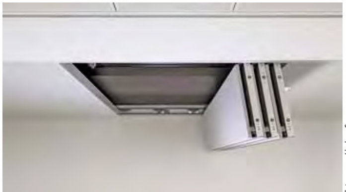
... ausgestattet, die einen werkzeuglosen Zugang zum Deckenhohlraum ermöglicht.
