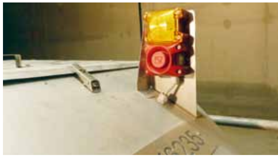
Im voll ausgebauten Gleinalmtunnel sorgen 160 Blitzschallgeber PA X 1-05 mit einer Blitzfrequenz von 1 Hz aus der PATROL-Serie von Pfannenberg für eine zuverlässige Brandalarmierung in den Abluftkanälen.
