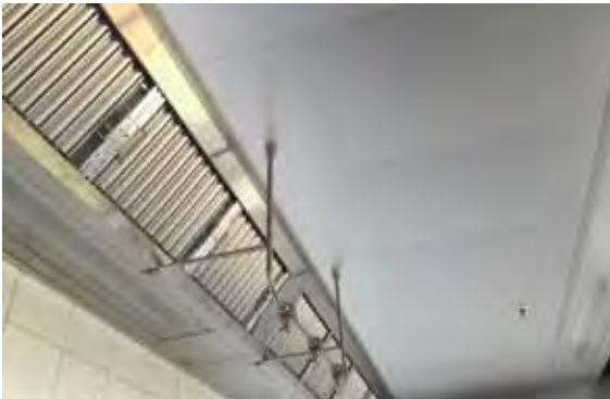
Nachträglich installierte Feuerlöschbrücke über dem Kochblock
