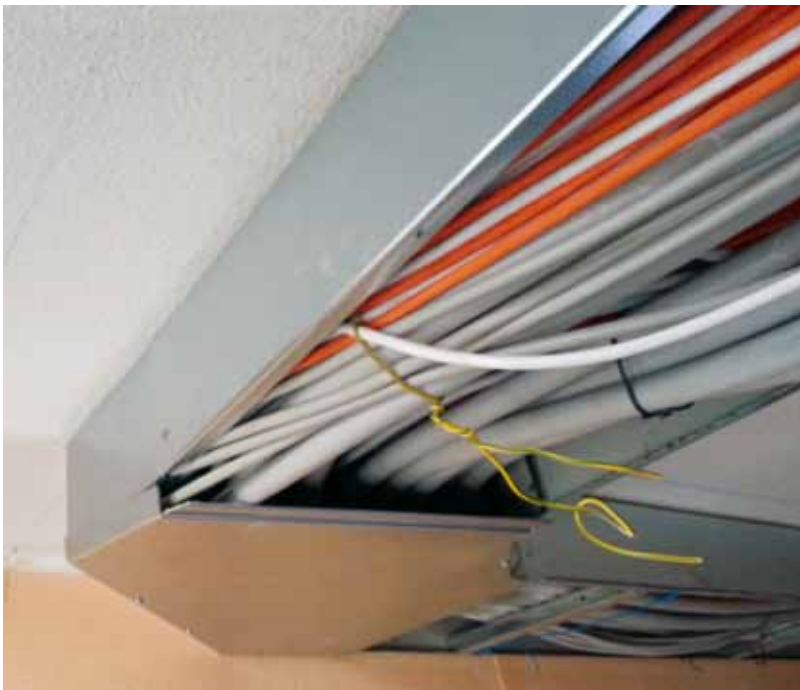
Kabel im I-Kanal
