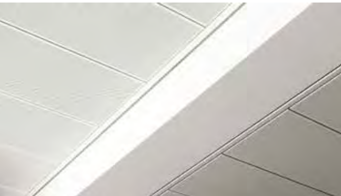
Die Flur- und Fluchtwegbereiche der Medienakademie wurden mit der Lindner Brandschutzunterdecke „LMD F30 TIPmotion“ ...
