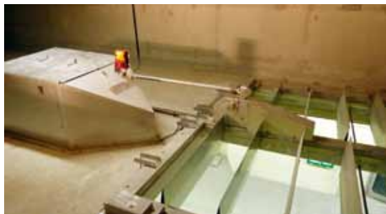
Geöffnete Lüftungsklappe im Gleinalmtunnel mit Blick in die darunterliegende Verkehrsröhre. In den beiden Abluftkanälen sind je rund 80 Lüftungsklappen verbaut, die im Brandfall auch der gesteuerten Rauchabsaugung dienen.
