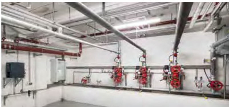
Die neue Sprinklerzentrale bietet ausreichend Platz für eine spätere Erweiterung der Löschanlage.
