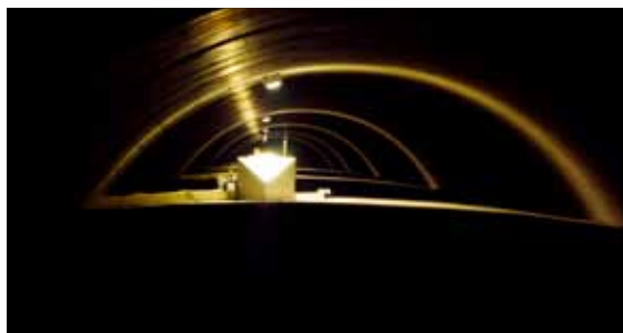
Die beiden Abluftkanäle gestatten dem zuständigen Personal den Zugang für Wartungsarbeiten. Bei einem Brandalarm ist es dringend notwendig, dass der betreffende Abluftkanal so schnell wie möglich evakuiert wird.
