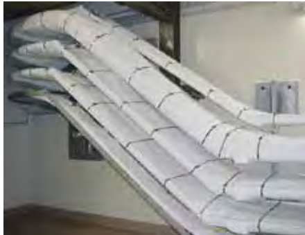
Kabelbandage in Rettungsweg
