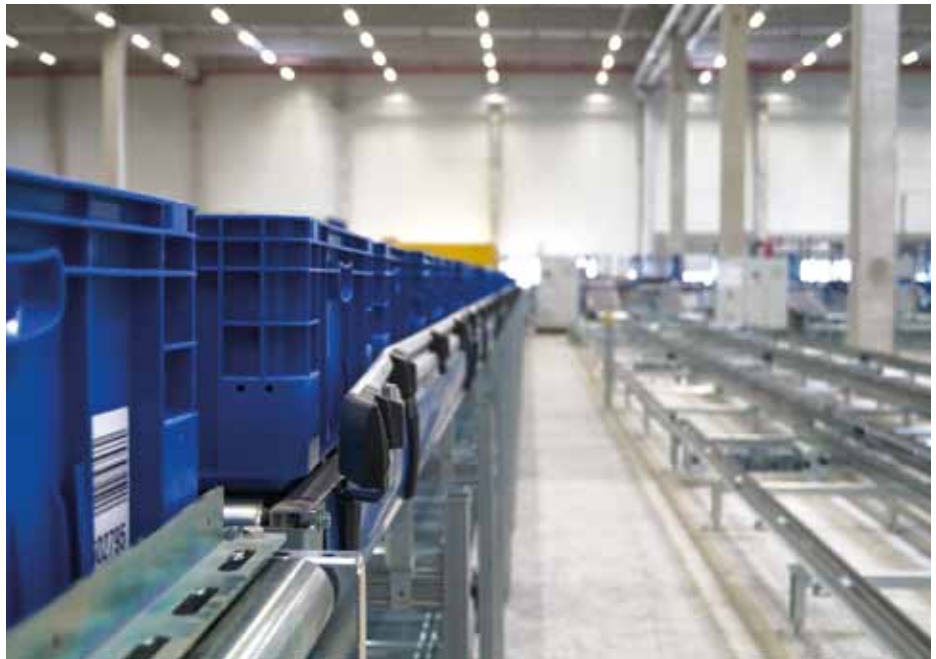
Das vollautomatisierte Hochregallager mit Kleinladungsträgern der Imperial Automotive Logistics GmbH wird mittels Ansaugrauchmeldesystemen sowie aktiver Brandvermeidung vor Brandgefahren geschützt.
