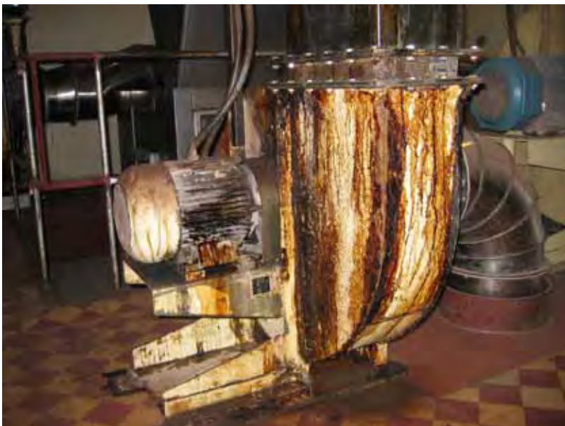
Der verölte Abluftventilator ist eine gefährliche Brandlast
