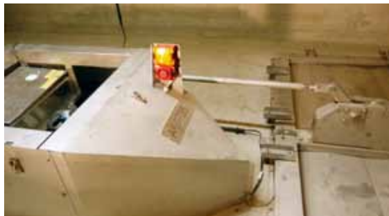
Im Brandfall erfolgt die optische und akustische Alarmierung über die Pfannenberg-Signalgeräte. Erst nach der bestätigten Räumung darf die Rauchabsaugung gestartet werden.
