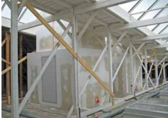
L90-Kanäle verbinden die RWA-Systeme Typ „Firefighter“ in der Zwischendecke mit den RWA-Systemen Typ „Smokejet“ in den trigonalen Oberlichtern. Die Systeme sind zu Wartungszwecken über Brandschutztüren erreichbar.
