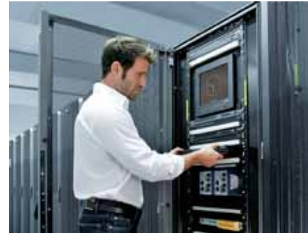
Die Gefahrenmeldeanlage „UGM 2040“ ist das „Gehirn“ des integrierten Sicherheitssystems.
