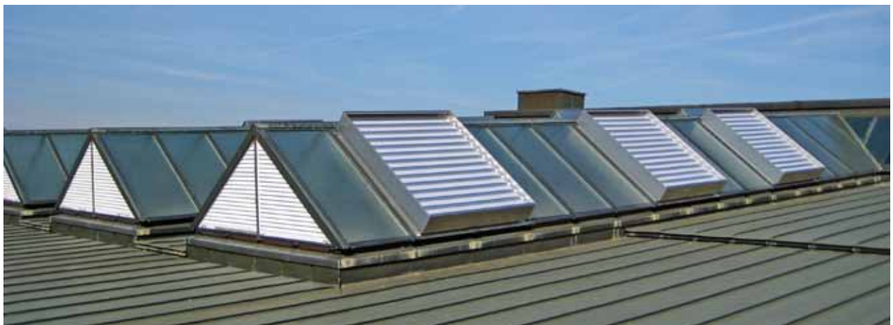
Vier der in den Lichtbändern verbauten sechs RWA-Systeme Typ „Smokejet“ dienen dem Rauchabzug im Brandfall. Zwei Systeme werden lediglich zur Lüftung eingesetzt.
