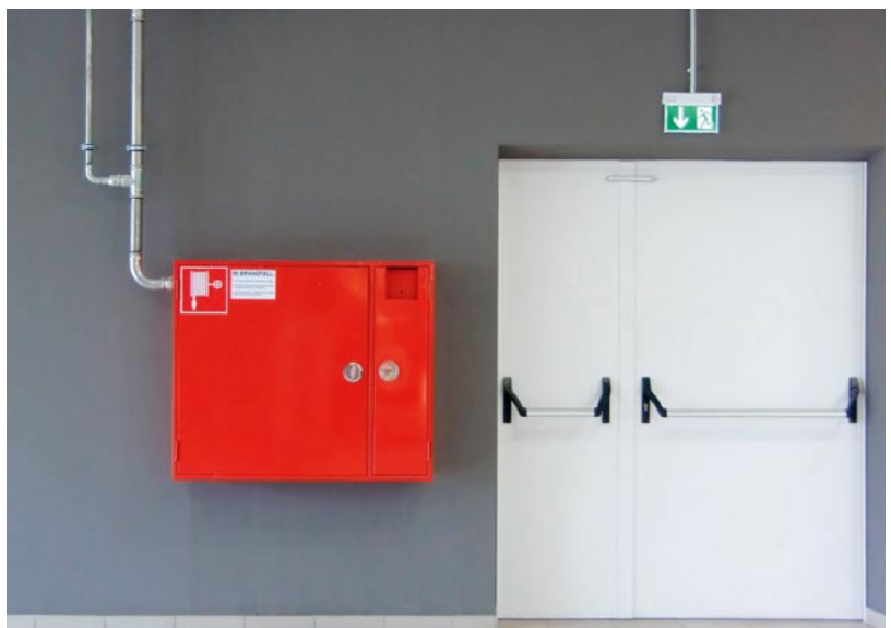
Löschwasseranlagen mit Wandhydranten ermöglichen erste Maßnahmen zur Brandbekämpfung. Die geltenden Normen und Regelwerke fordern hierfür allerdings auch die Erhaltung der Trinkwassergüte entsprechend der Trinkwasserverordnung.
