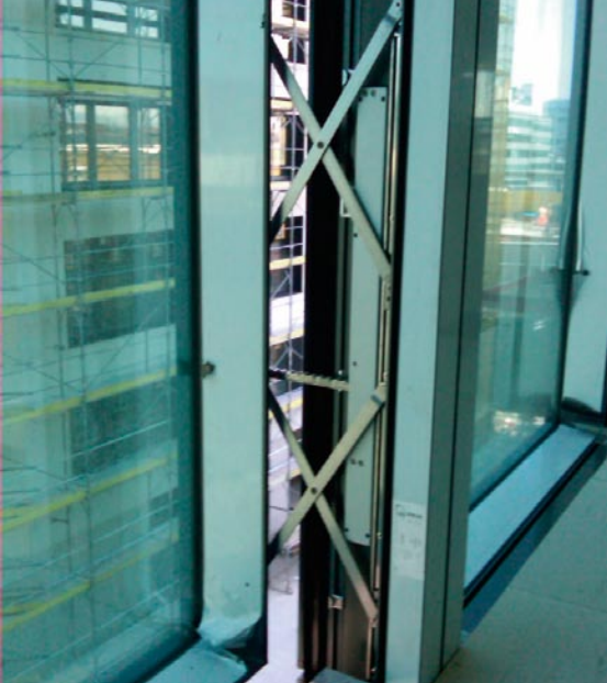
Sicherheits-Abluft über die Außenfassade.
