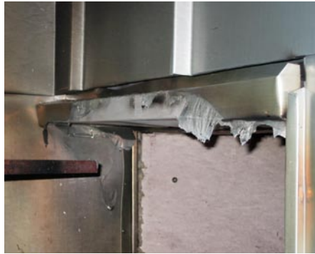
Fenstersturz nach Brandprüfung: kleine Schäden.
