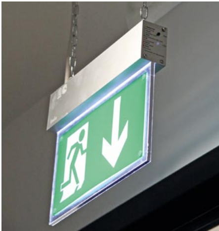
Klassische beleuchtete Fluchtwegweiser
