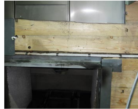
Aufgeschnittener Fenstersturz nach Brandprüfung: kaum erkennbare Brandeinwirkung.
