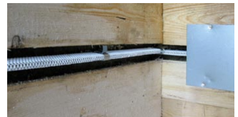
Unterbrochene Holzschalung mit Brandsperrern.
