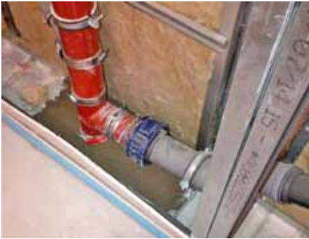
Die Ausführung vor Ort unterliegt einer strengen Qualitätskontrolle. Erst nach Verschluss und Abnahme der brandschutzrelevanten Durchführungen, dürfen die Wände geschlossen werden.
