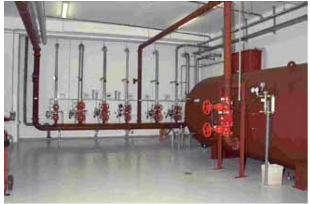
Für die jeweiligen Brandabschnitte sind an vielen Stellen Sprinklerzentralen errichtet, welche die entsprechenden Bereiche mit Löschwasser versorgen.
