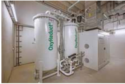
Die „OxyReduct“-Anlage senkt die Sauerstoffkonzentration unter die Entzündungsgrenze der im Lager vorherrschenden Materialien ab.
