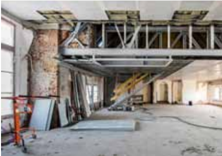
Der etwa 1,70 m hohe Höhenversprung im Deckenverlauf wurde ebenfalls mit einer doppelten Lage aus 2 x 20 mm „Aestuver“ Brandschutzplatten bekleidet.
