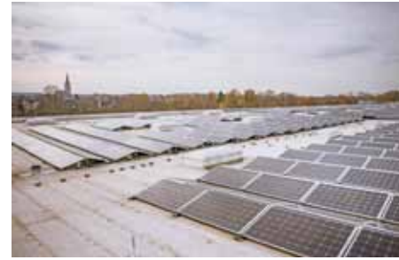
Die Photovoltaikzellen auf dem Dach des Lagers liefern bis zu 500 kWh pro Jahr – und versorgen u.a. die „OxyReduct“-Anlage mit nachhaltig produziertem Strom.
