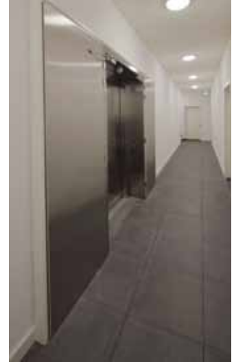
Feuersicherer Aufzug. Im Brandfalle schließen die von Magneten gehaltenen Brandschutztüren automatisch, können aber weiterhin geöffnet werden.
