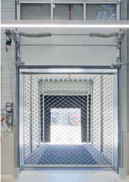
Die an ausgewählten Verladeschleusen montierten, zusätzlichen acht Rollgitter gestatten ein effektives Querlüften der Versandhalle bei aufgefahrener Sektionaltoren, ohne dass Unbefugte diese Halle betreten können.
