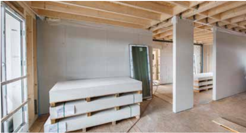
Mit fermacell Gipsfaser-Platten sowie Trockenestrich-Elementen konnte bei der Aufstockung der 4 Siedlungshäuser ein von der SächsBO abweichendes Brandschutzkonzept realisiert werden, das gemäß Brandschutznachweis die Schutzziele des Bauordnungsrechtes voll erreicht.
