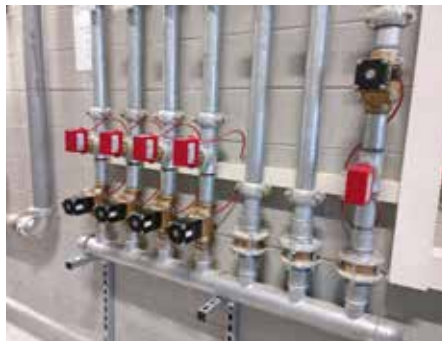
Stickstoffverteiler mit elektrischen Steuerventilen.
