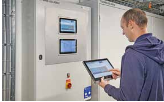
Via Tablet können über die von Systemair realisierte, integrierte Steuerung die Parameter der Rauchschutz-Druckanlage fernabgefragt und präzise nachjustiert werden.
