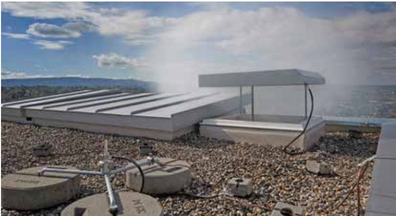
Durch den unterstützenden Dachlüfter konnten die Abströmkanäle kompakt gehalten werden.
