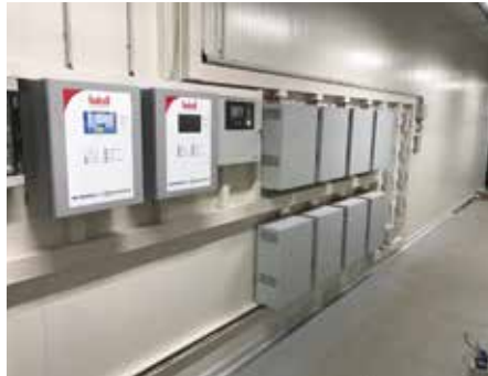
Ausfallsichere, redundante Anlagensteuerung.
