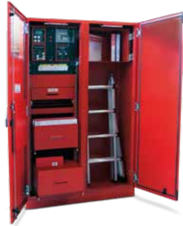
Eine Feuerwehr-Anlaufstelle (FAS) enthält neben einer FIZ weitere individuell zusammengestellte Komponenten.
