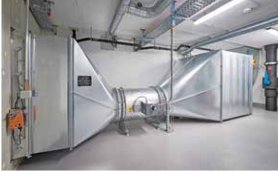
Der Axiallüfter „AXC 710“ sichert die Überdruckhaltung im Sicherheitstreppenhaus. Die Schalldämpfer sorgen für einen Schallpegel unter 70 dB im Raum.
