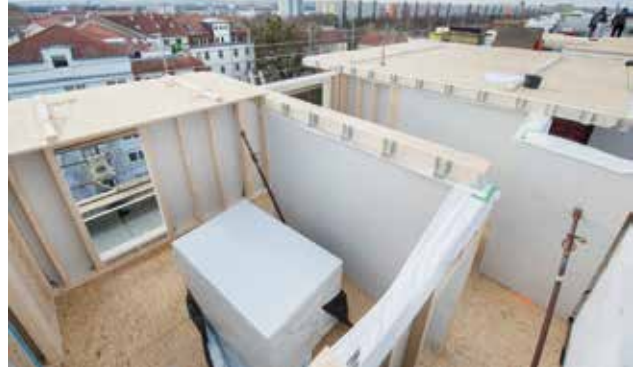
Neben der Lösung der statischen Problematik bot die Holzbauweise weitere Vorteile: Die Maßnahme konnte so in relativ kurzer Bauzeit bei geringem Baulärm durchgeführt werden.
