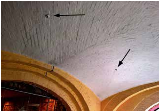
Sprinkler in der historischen Decke.
